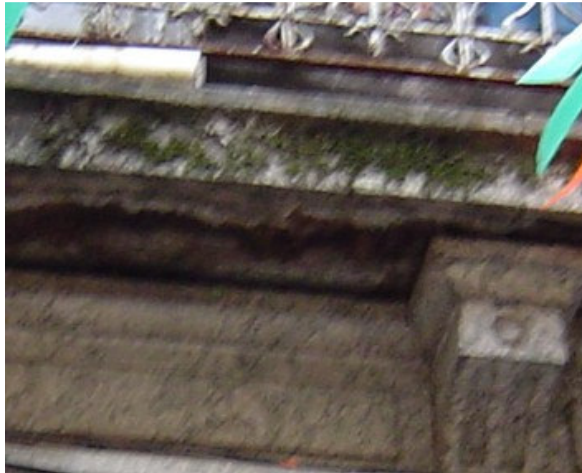
Figura 45 - Detalhe da biodegradação pelo crescimento de algas e musgos. Fonte: Ghetti, 2003.
