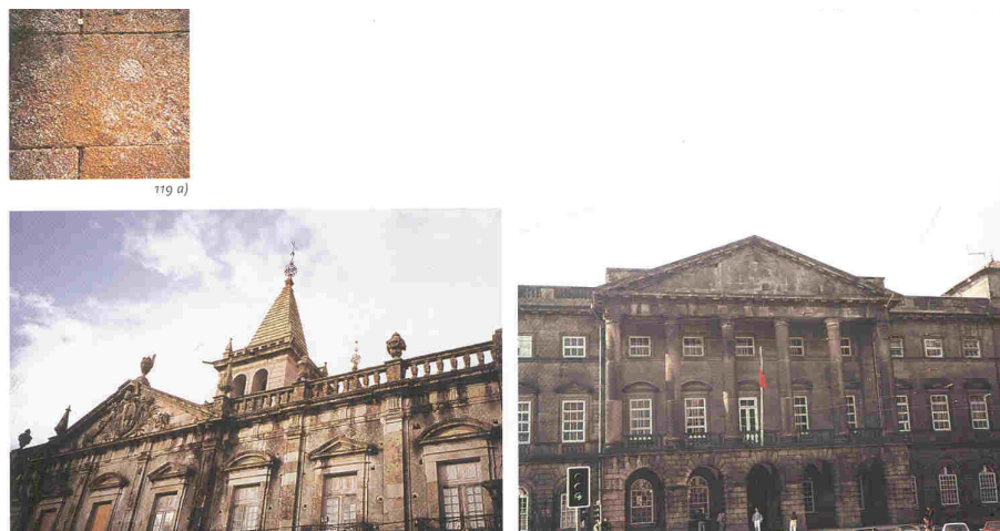
Figura 17 - Exemplo de degradação do aspecto de obras em granito, causada por fixação de organismos vivos e aderência de partículas sólidas de natureza orgânica e inorgânica. Fonte: MOURA, 2000.p.108.
